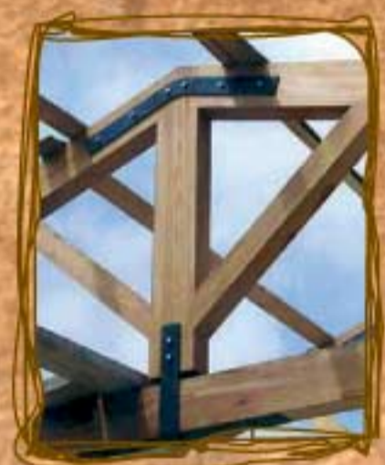
Estructura Postes Cuadrados
